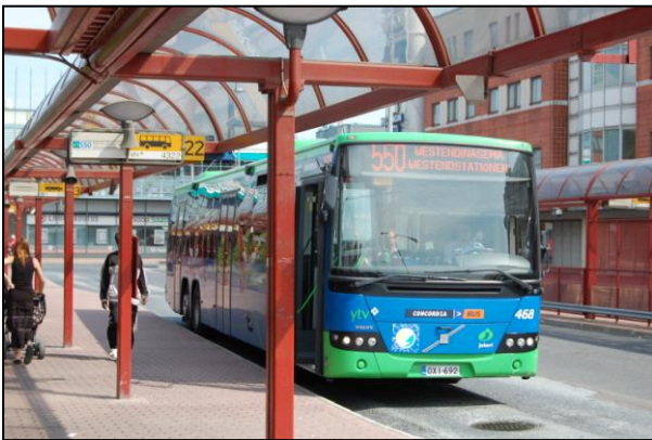
Kuva 8. Itäkeskuksen terminaalin katokset näyttävät punaruskeina ruostuneilta.
